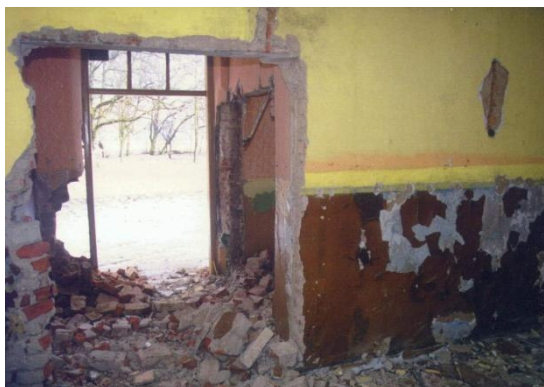
250. Oleszno. Widok z hallu w kierunku ganku i głównych drzwi wejściowych. Stan z dnia 2001-02-25.
