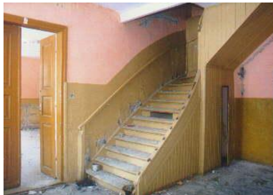
251. Oleszno. Hall, widok zniszczonej poręczy z balustradą. Stan z dnia 2001-02-25.
